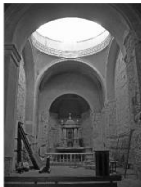
Capilla de la Veracruz, a punto para su restauración
